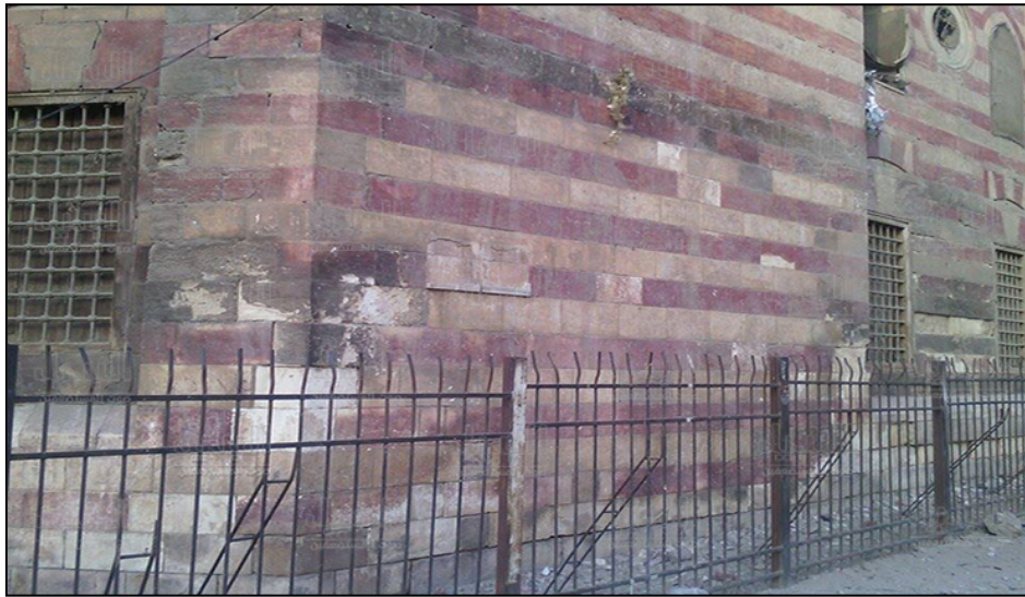
صورة (7): توضح تلف الأحجار الخارجية للمدرسة بسبب المياة الأرضية والتلوث الجوي ، مما يستدعي التدخل بالترميم لحماية المدرسة وإعادة تأهيلها.
